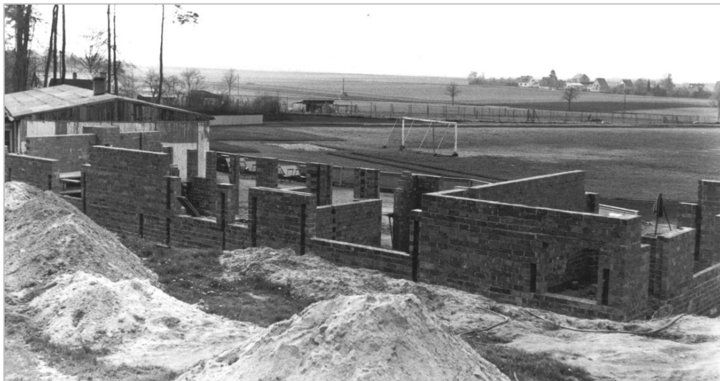
Die Baustelle des Sportheims 1965. Vorne rechts der spätere Ballraum. Links hinten die Tischtennisbaracke. Das Fußballfeld wurde von einer Aschenbahn umgrenzt. Im Hintergrund die Häuser von Unterfürberg.
